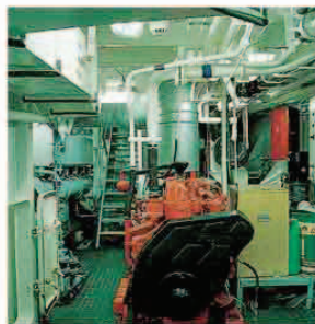
la sala de máquinas engine room
